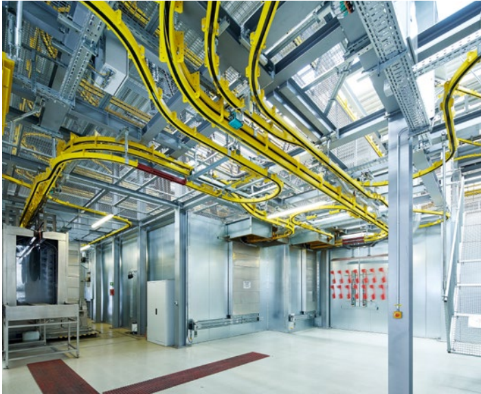
Von der Vorbehandlung erfolgt der Weitertransport durch den Haftwassertrockner, in dem die Bauteile mit einer für alle Laufwerke gleichen Zeit bei 150 °C verweilen. Quelle (zwei Fotos): Schierholz
