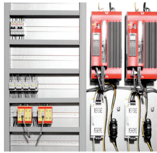
3 Schaltschrankaufbau mit zentralem Sicherheitswächter „Movisafe® UCS“ und Frequenzrichter
