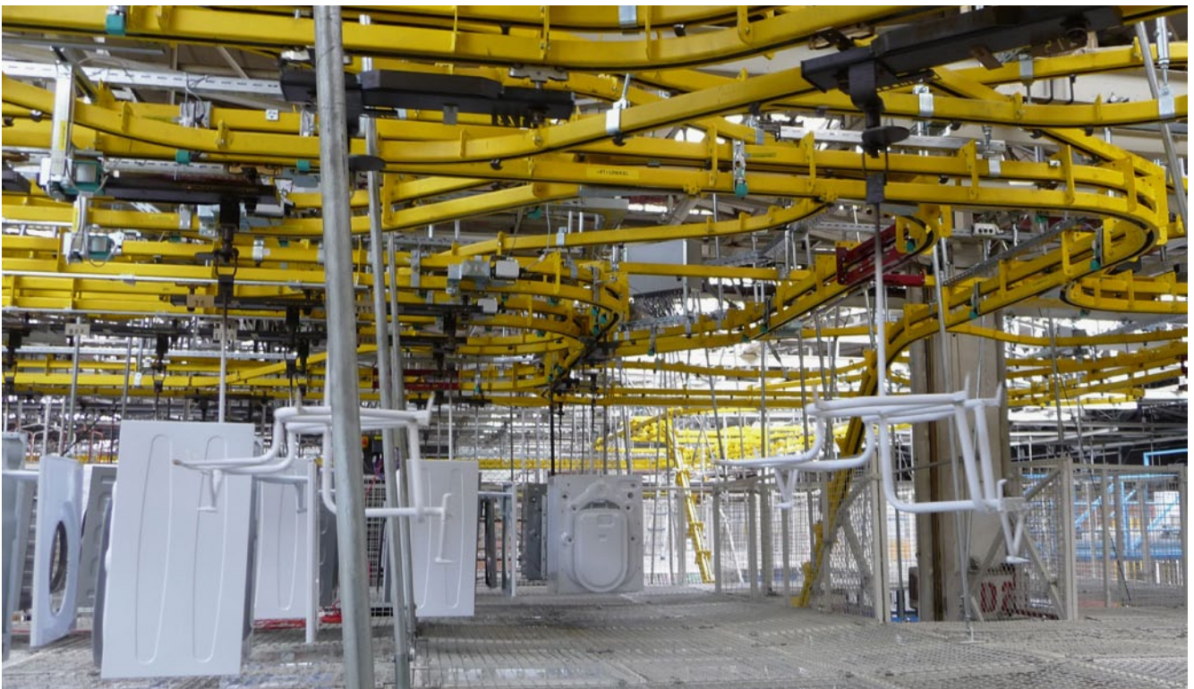
Speicherauslauf für lackierte Teile der Power + Free-Anlage, die unter anderem mit 1200 zweifachen Laufwerken für eine hohe Kapazität sorgt
