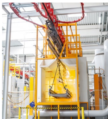
Einfahrt in die automatische Pulverbeschichtung. Neben Kleinteilen transportiert der Förderer auch große, schwergewichtige Teile von Schmalgangstaplern mit einem Gewicht bis zu 4000 kg.
