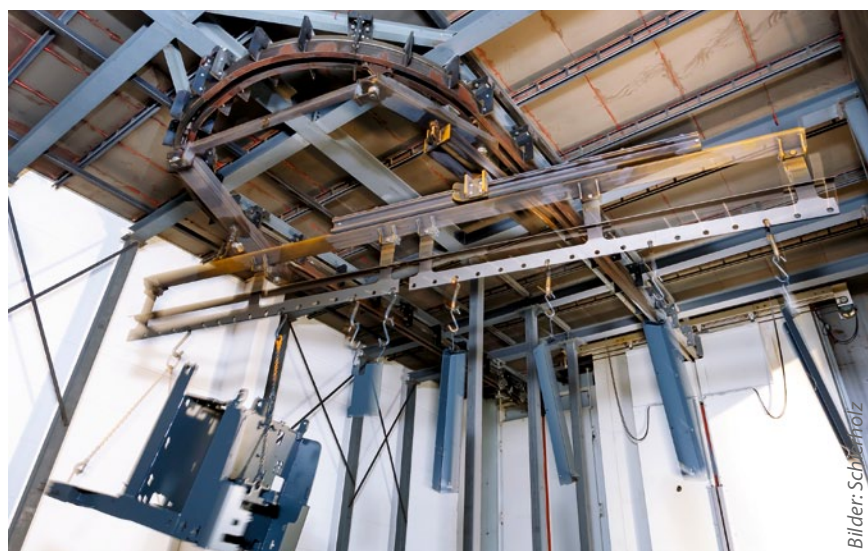
Laufwerk mit Verschiebetraverse in Kurvenfahrt. Bis zu sieben Meter lange Gabelstapler-Elemente können sicher durch extrem enge Kurven bewegt werden.
